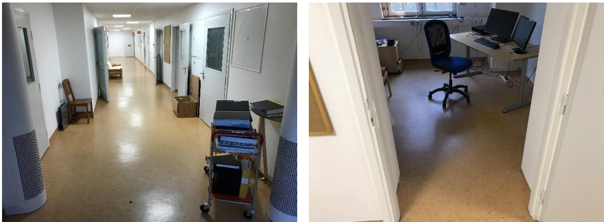
De flesta golvytorna är belagda med någon form av plastmattor. Golvmattor av PVC äldre än år 2000 innehåller ftalater och ska klassas som FA. Limmet underliggande golvmattorna kan innehålla asbest.
