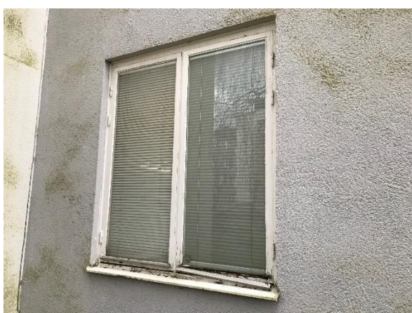
Flera fönster påvisar kraftiga rötskador.
