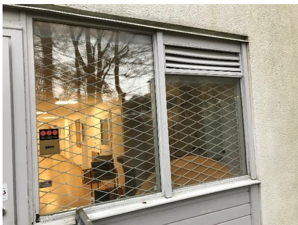
Rötskadat fönster på baksidan av huset.
