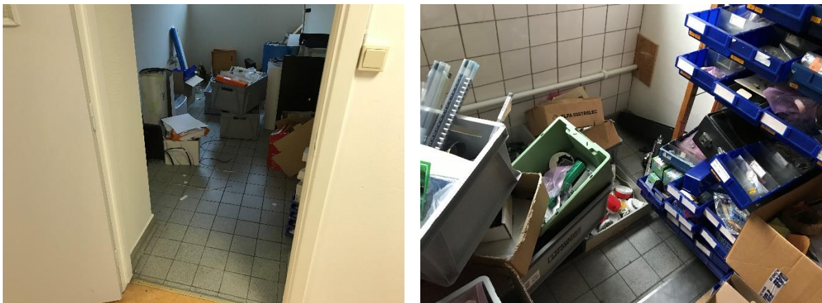
Övriga utrymmen där asbest kan finnas i fogen eller fästbruket bakom kakel och klinkers.
